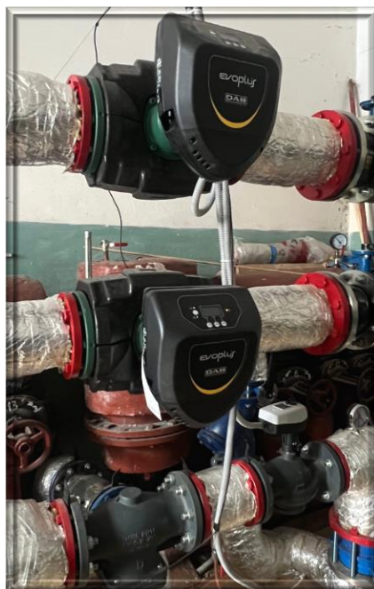
Рис. 8.17 – Індивідуальний тепловий пункт
