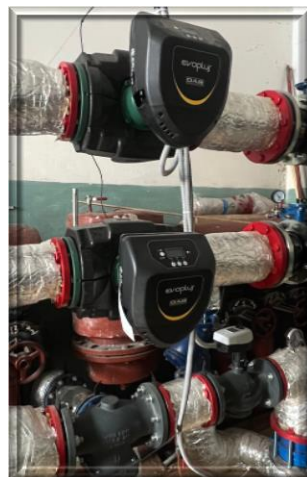
Рис. 8.17 – Індивідуальний тепловий пункт
