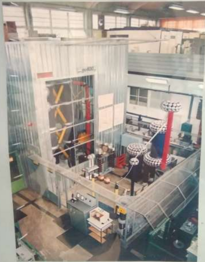
Widok ogólny Laboratorium Wysokich Napięć
